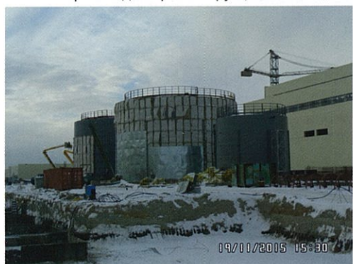
На фото: Циркуляционные водоводы
