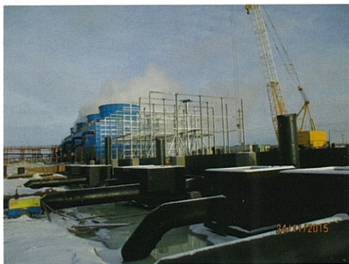
На фото: Баки запаса подпиточной воды теплосети
