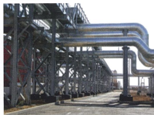
Фото: 2012г. Эстакада соединительных трубопроводов между водогрейной котельной и насосной 1-ого подъема ТЭЦ-2
