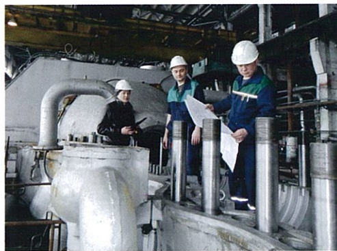
На фото: Тюкалов А.В. инженер ПТО, Тыртышный А.А. руководитель ремонта т.а. 5, Чередниченко Е.В. прораб РЦ-2 на монтаже турбины №5.
